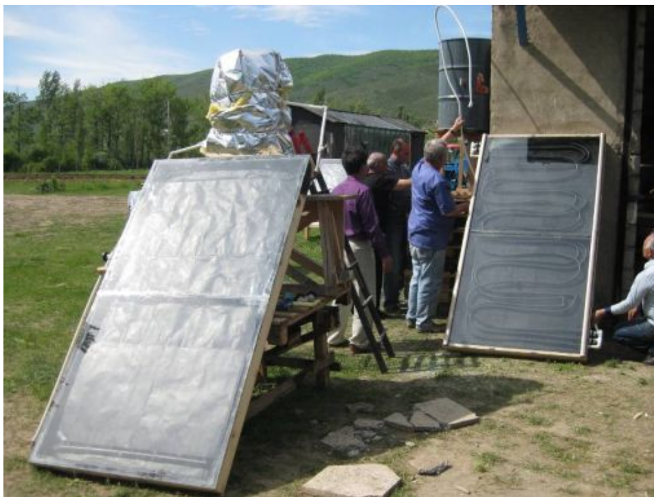
à gauche: panneau en cuivre, à droite : panneau en plastique
