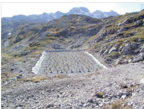
Изкуствена влажна зона за пречистване на сивата вода в планински район Форарлберг, Австрия
