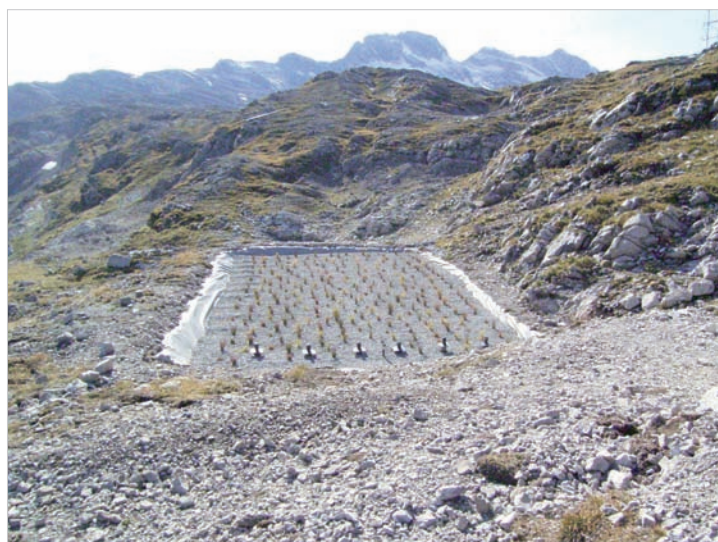
Zonă umedă pentru epurarea apei gri în regiunile muntoase din Vorarlberg, Austria
