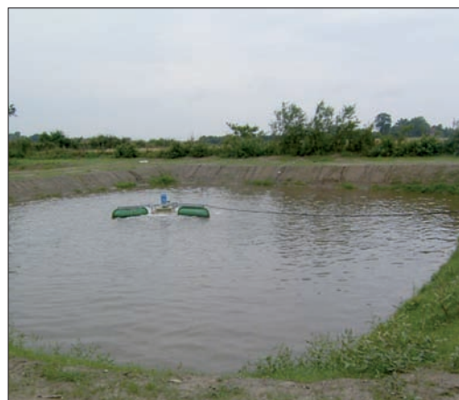
Bazin de aerare 3, aerator de suprafață
