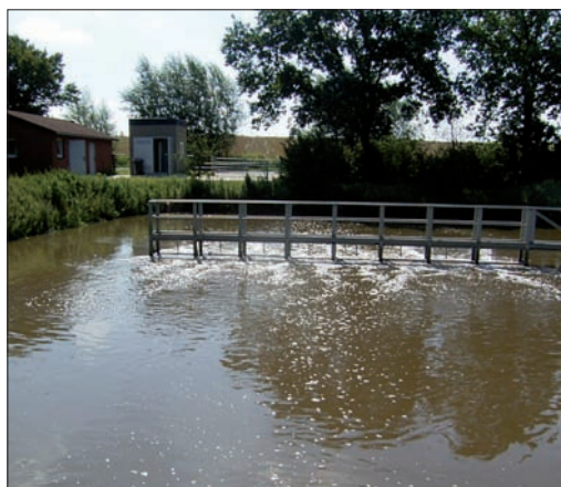
Bazin de aerare 1, în clădirea operativă, situată în spate (în stânga) și clădire în care este dispusă partea de separare a materialelor
