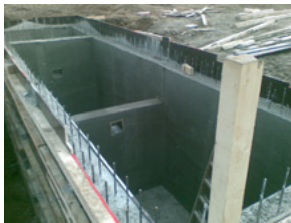
Стъпало предварителна обработка: събирателен резервоар от две камери. Трета камера изпомпваща шахта
