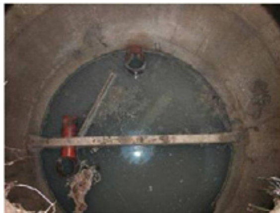
Поглед в събирателния резервоар за предварителна обработка на сива вода
