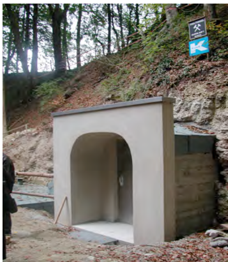
Вход на водохващане на извор
