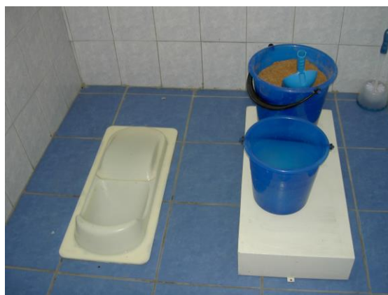
Interior al unei toalete cu sistem de separare a urinei pentru o școală
