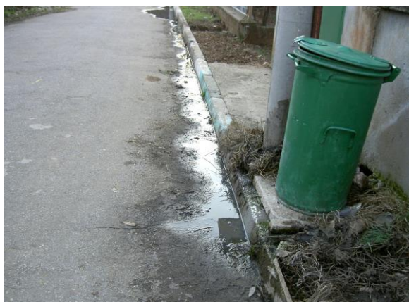
O stradă poluată cu apă uzată de la o fosă septică supraîncărcată
