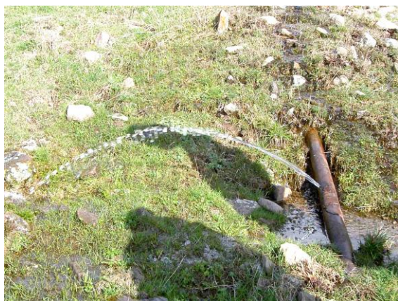
Coroziunea poate provoca fisuri grave în sistemul de distribuție al apei
