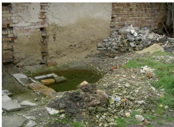
O groapă de canalizare umplută cu apă uzată
