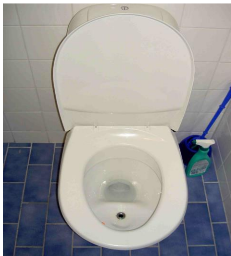
Toaletă cu sistem de separare a urinei, cu spălare
