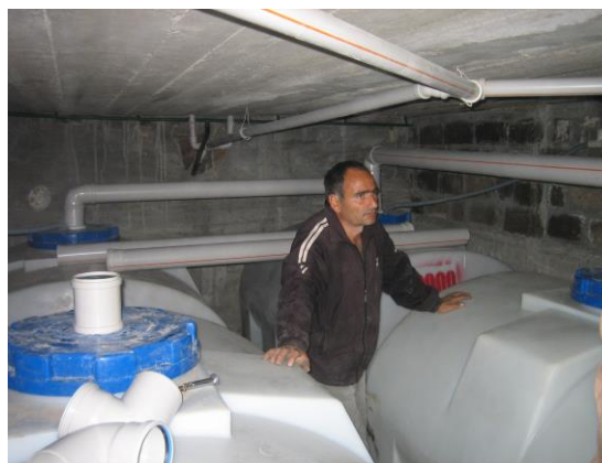
Toaletă cu sistem de separare a urinei în școală: subsol cu rezervoare pentru colectarea, depozitarea și epurarea urinei pentru 350 de utilizări
