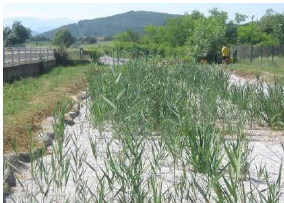
Filtru de sol cu trestie plantată în Vidrare, Bulgaria
