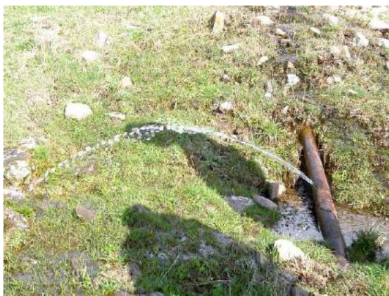
Coroziunea poate provoca fisuri grave în sistemul de distribuție al apei
