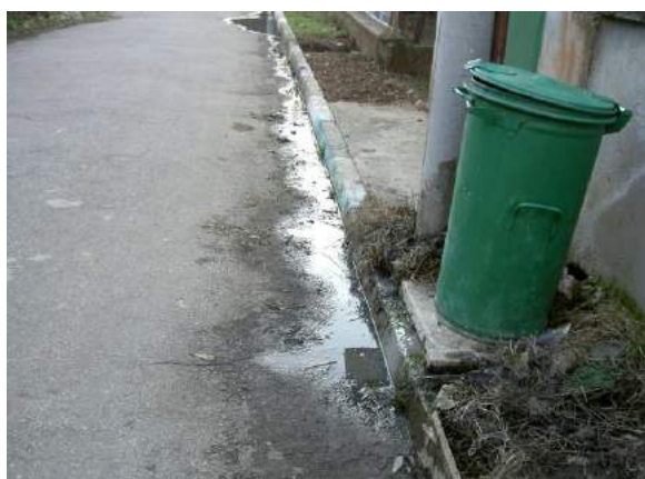
O stradă poluată cu apă uzată de la o fosă septică supraîncărcată
