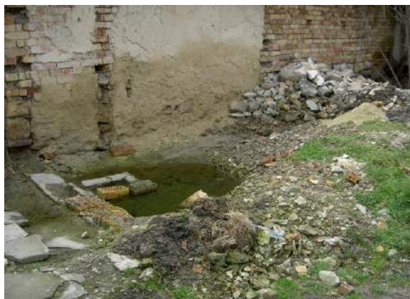
Un puț absorbant umplut cu apă uzată
