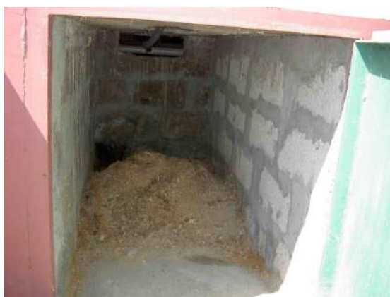
Toaletă cu sistem de separare a urinei în școală: încăperea pentru colectarea, depozitarea și epurarea materiilor fecale
